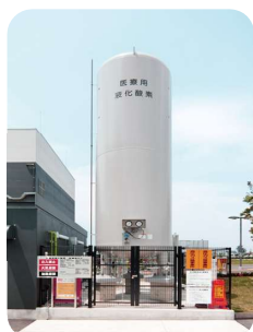
病院の外に設置された液体酸素のタンク (写真は前橋日赤様)
